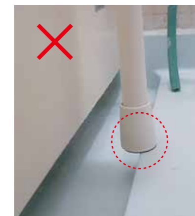
脚キャップが完全に接地していない
