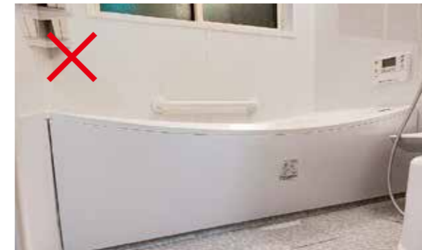
浴槽縁が中央に傾斜している
