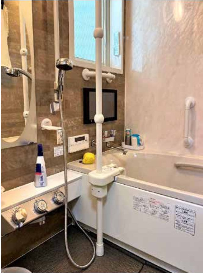
エプロンに強度がない浴槽
